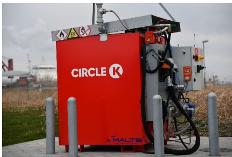
Abbildung 4: Circle K - Methanoltankstelle 5
